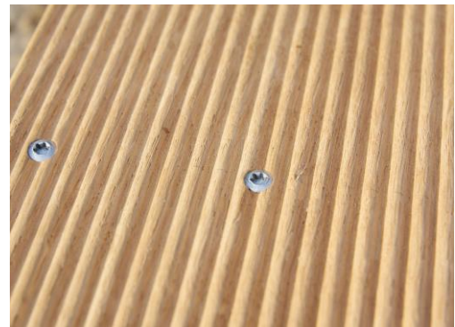
HECO_Etang de glace_pas d'effet de fissuration.jpg
